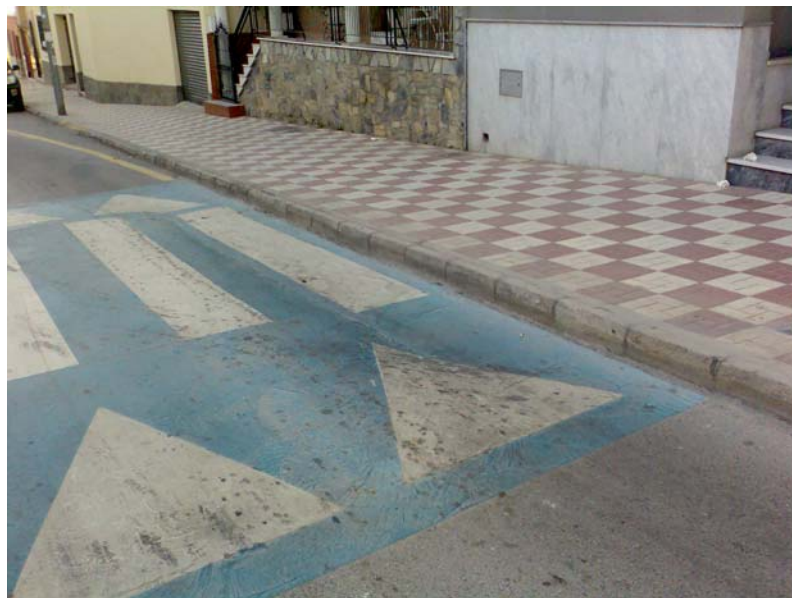
Fotografía 9 Lomo en paso de cebra sin rebaje
