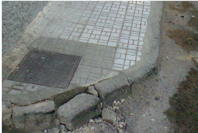
Fotografía 8 Bordillo en mal estado y sin rebaje. Cº San Antonio
